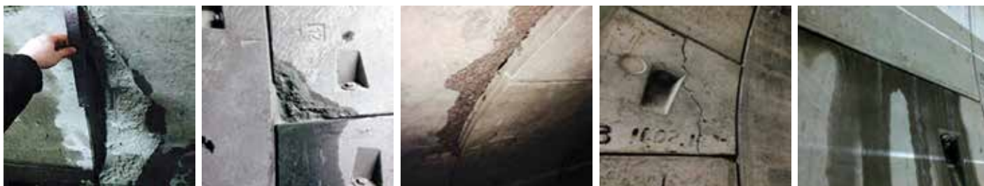
Рисунок 4.9. Сколы, трещины и течи в сборной водонепроницаемой обделке из высокоточных железобетонных блоков
