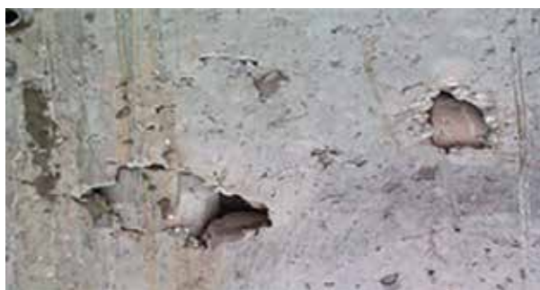
Полости от зависания бетонной смеси
